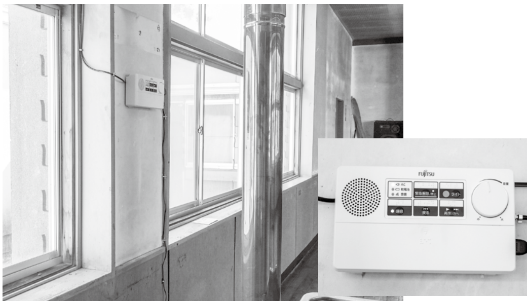
広瀬公民館内に設置された戸別受信機
