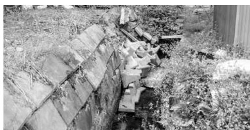
高根地区の用排水路の崩れた箇所
