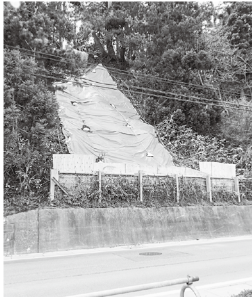
応急措置された国道280号そばの崩れたのり面
