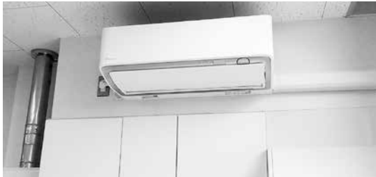
現在エアコンの設置は保健室だけ
