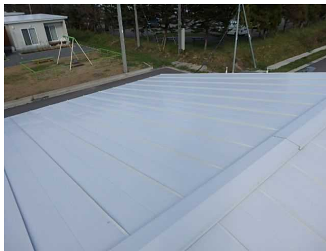
屋根破損状況
