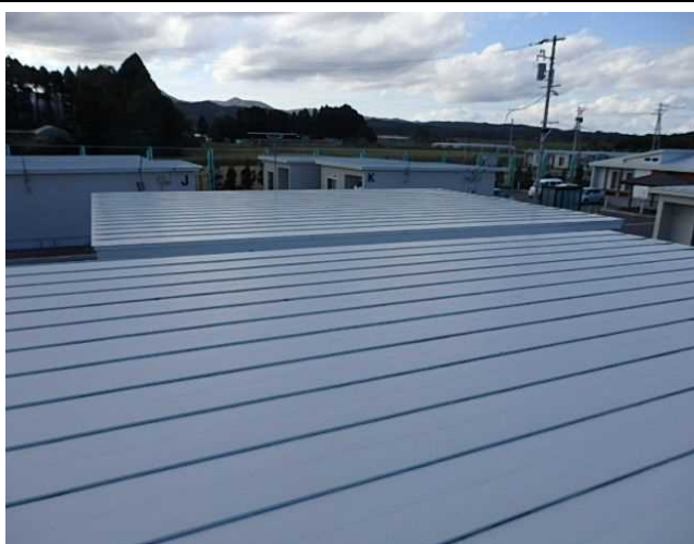
屋根破損状況
