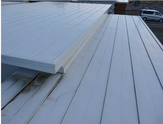
屋根破損状況
