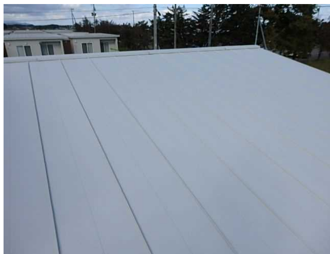
屋根破損状況
