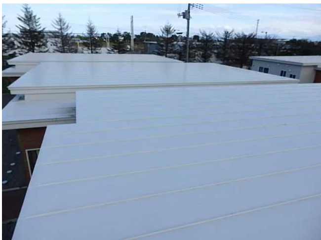
屋根破損状況
