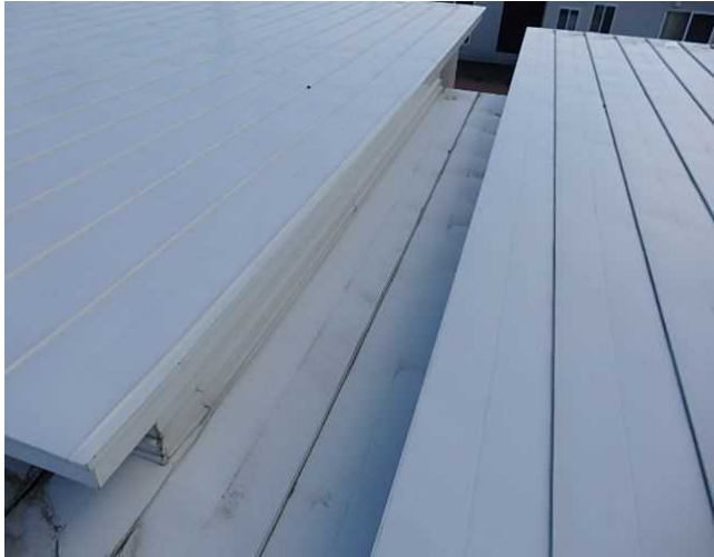
屋根破損状況
