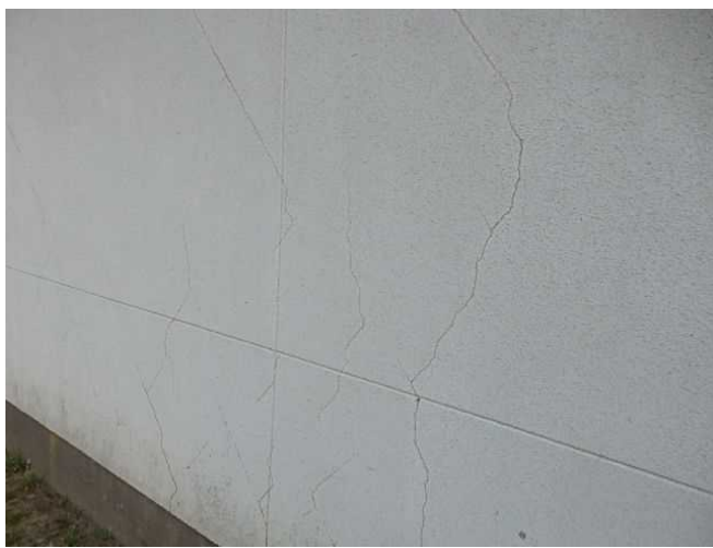
外壁破損状況
