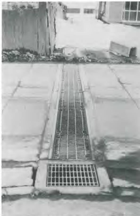
振動被害が出ている排水溝(幼稚園前)
