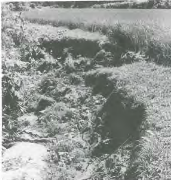
…瀬辺地川上流水害…
